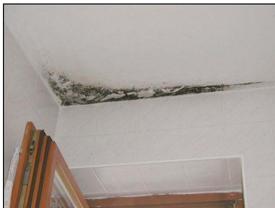
Abbildung 5: Schimmel im Bereich eines Geschosdeckenan schlusses
